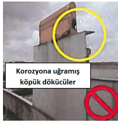
Şekil 35 Korozyona uğramış köpük dökücüler
